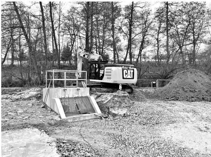
Drosselbauwerk im neuen Regenrückhaltebecken
